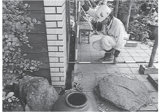
被災家屋の玄関のずれ
