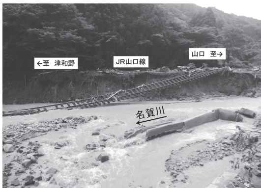
名賀川はん濫による JR 山口線被災状況 (津和野町名賀地内)
