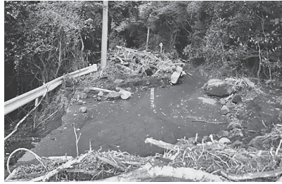
被災状況②
