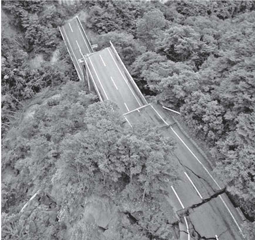
国道342号 落橋した祭時大橋
