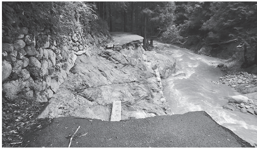
市道流失状況（H29.9.20撮影）
