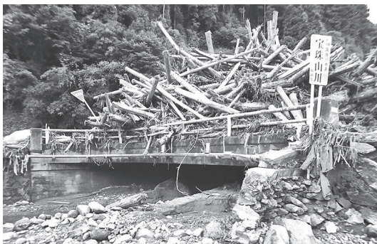
写真－3 橋梁に捕捉された大量の流木
