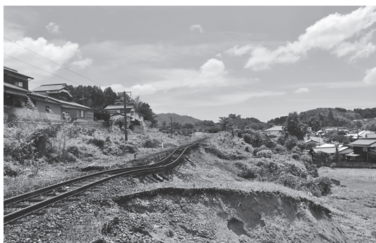
写真-3 JR岩徳線の被災状況
