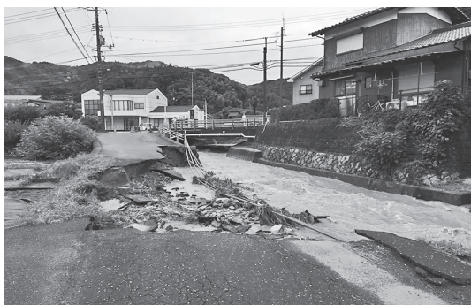
写真-5 河川氾濫による市道災害状況
