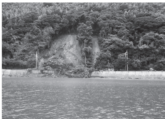
写真-7 市道本浦馬島線の災害状況
