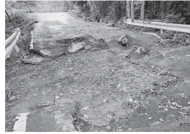
写真-3 道路崩落
