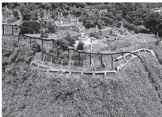
写真-4 被災状況（ブロック頭部の段差亀裂）
