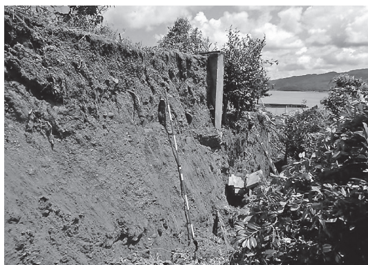
写真-5 被災状況（滑落崖 H=2.5m）
