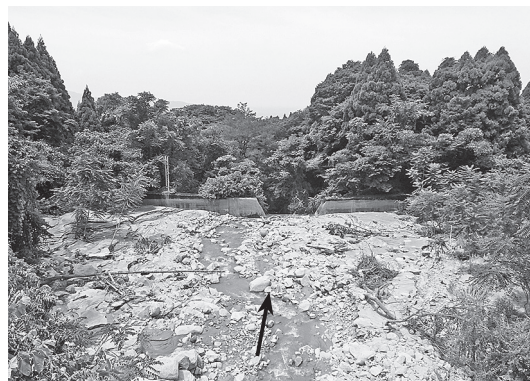
写真－1 満砂状態となった大毛谷川堰堤
