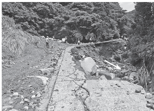
写真－７ 大きく侵食された溪流
