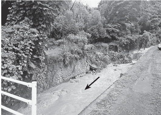
写真-2 護岸が崩落した大毛谷川
