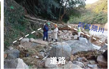
国道349号 土砂崩落・路肩流出
