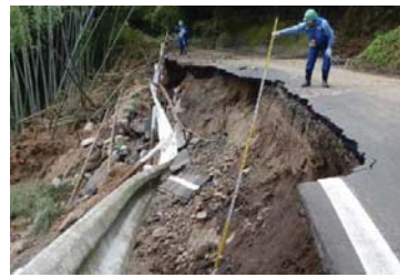
国道349号 路肩流出
