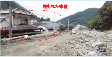
家は原形を保っているが、大量の土砂に埋もれている状態（土石流の場合には家は破壊される）
