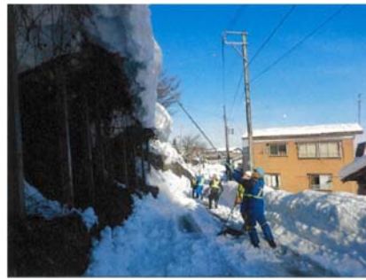
巻きだれを除去(新潟県)
