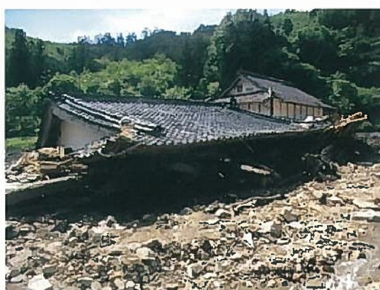
広島県庄原市の災害 (撮影：中国地方整備局)
