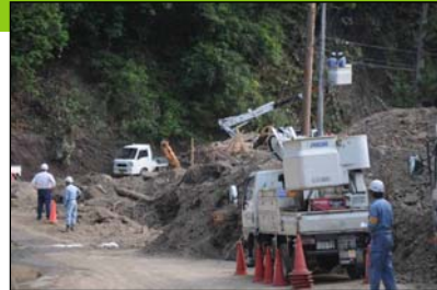
▲道路の崩壊で作業車輛入れず、復旧に遅れ
