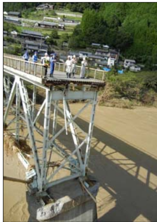
▲落橋した国道168号折立橋
