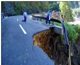
▲大雨により崩落した国道168号(桑畑)
