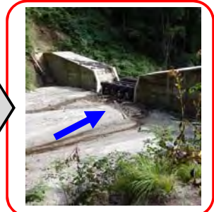
土石流発生直後 (H27.9.11)
