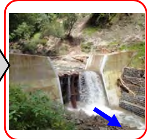
土石流発生直後 (H27.9.11)
